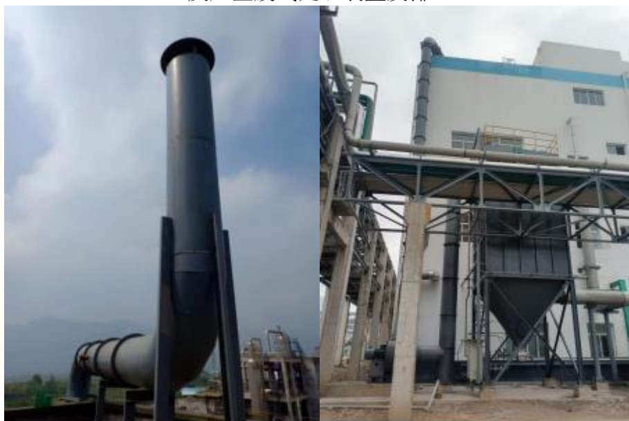
车间干燥废气处理设施及排口
