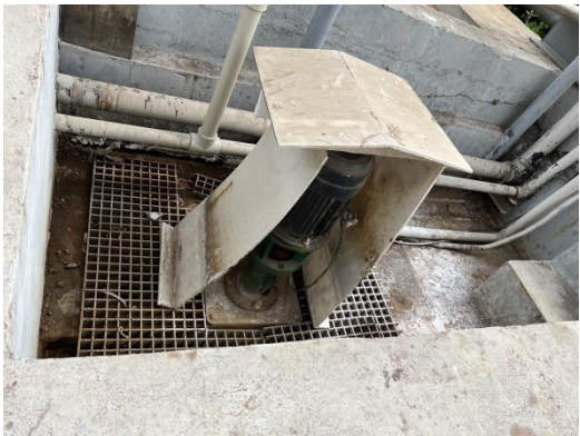
罐区收集池及抽水泵
