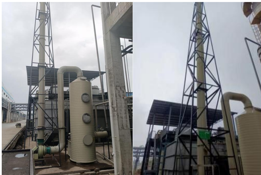
收氨尾气处理设施及排口
