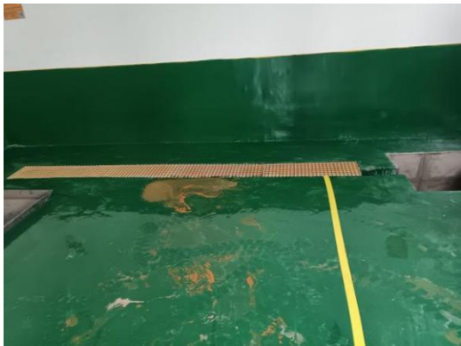
危废间导流沟及事故池
