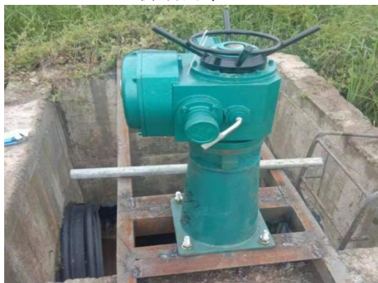
雨水管网切换阀
