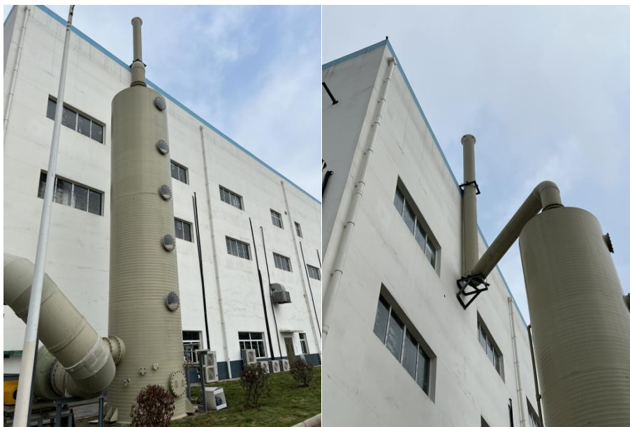
反应釜废气处理装置及排口
