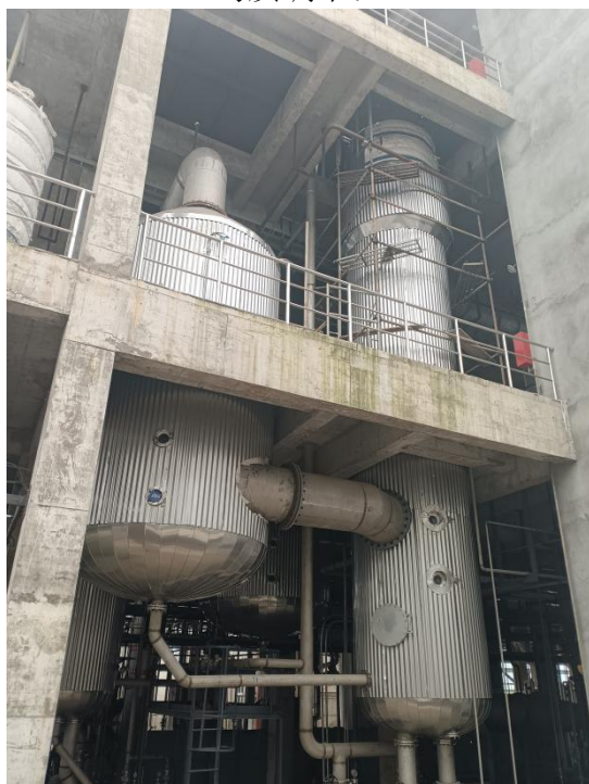
MVR 蒸发系统
