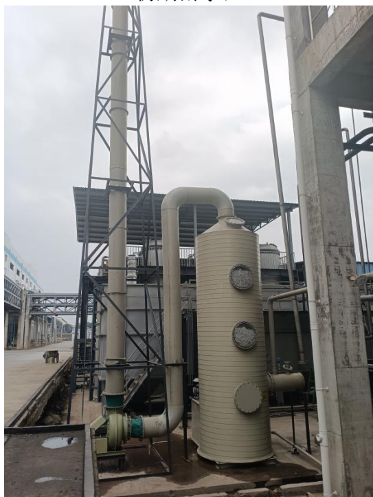
污水处理站酸洗塔
