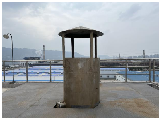
元明粉布袋除尘器排口
