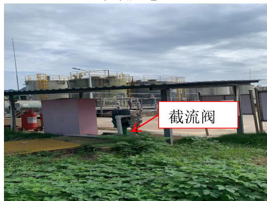
储罐区应急截流阀井
