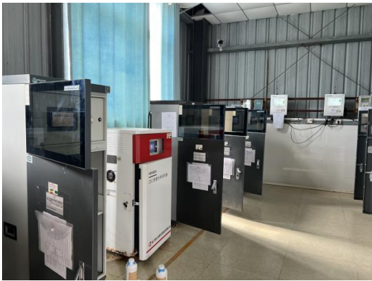
废水在线监测监控室
