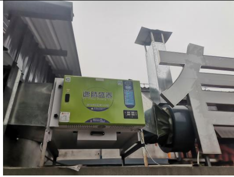
油烟净化设施区
